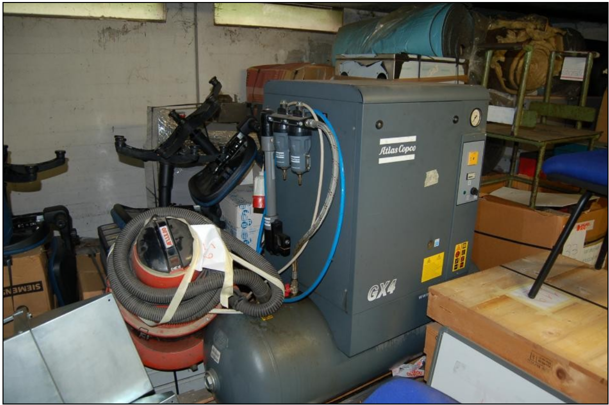
Foto n.24 – COME PRECEDENTE FOTO N.20 -IN PRIMO PIANO IL COMPRESORE "ATLAS COPCO GX4"
