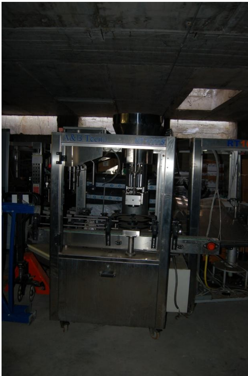
Foto n.40 – INTERNO MAGAZZINO SEMINTERRATO, CON IN PRIMO PIANO MACCHINA ENOLOGICA A&B TECNO RIMASTA INCOMPIUTA (TAPPATRICE)
